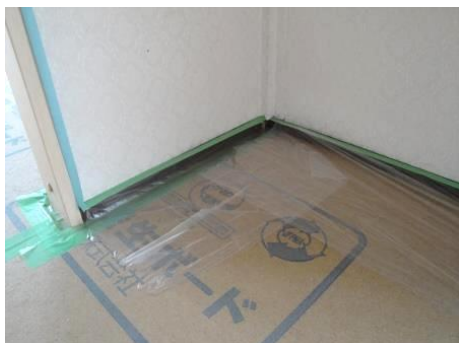
床にも漆喰が落ちます
